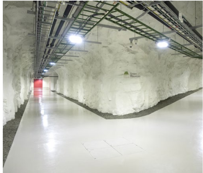
Abb.: Rechenzentrum Green Mountain DC1-Stavanger, Norwegen
